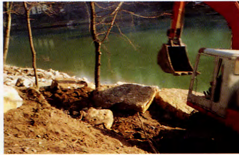
zicht op de site tijdens de werf view of the site during construction
